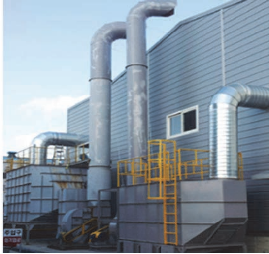
[그림 3.10] 흡착에 의한 시설 현장전경
