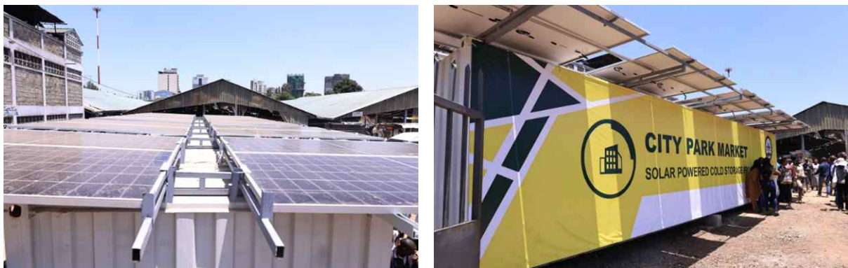
< CITY PARK MARKET에 설치된 태양열 냉장보관창고 >
